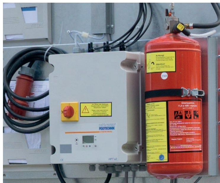
Afb. onder: PLC besturing, Geïntegreerde automatische brandblusinstallatie
